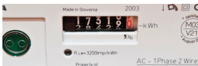
Energia elektryczna (licznik cyfrowy)
